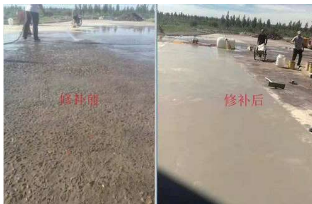
图二裂缝病害处理前后对比
