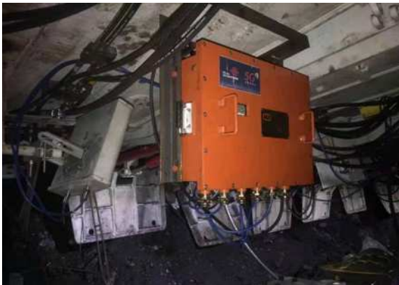
图1 煤矿井下5G基站
