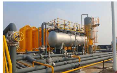
4.2.4-1 现场组复装完成的油气分离器撬
