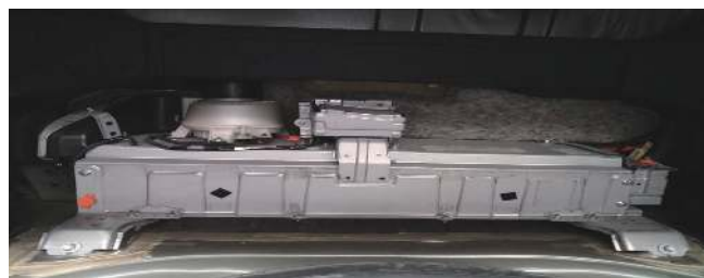
图 4 HV 蓄电池安装部位
