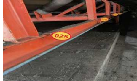
图 3 测温光缆安装位置
