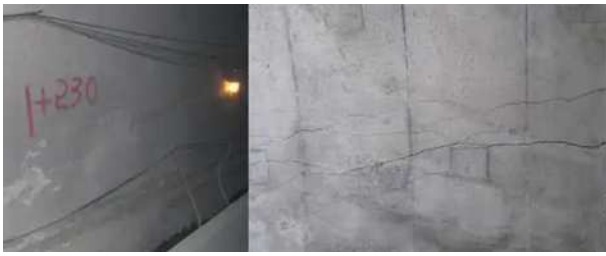
图1 冻害导致衬砌冻胀开裂
