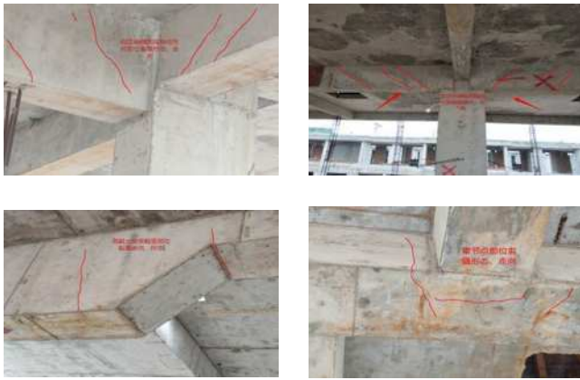
图 1-6 现场梁、板裂缝实照
