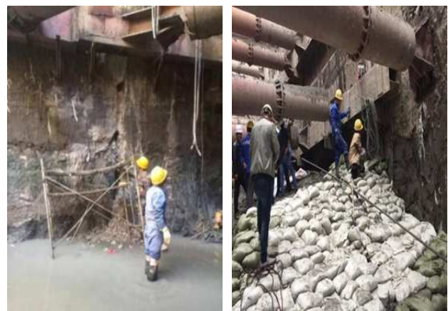
图 3-1 地连墙接缝渗漏
