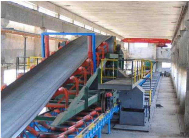
图1 发电厂输煤设备
