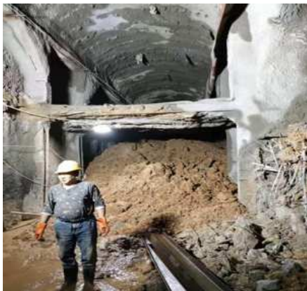
图 4 地铁车站小导洞内涌入大量水土
