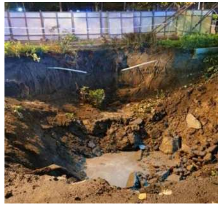
图1 管线渗漏引发某道路地面塌陷
