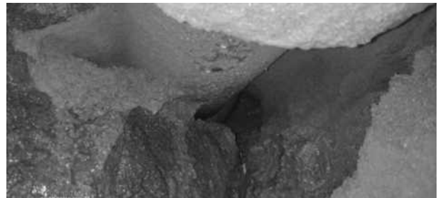
图 6 雨污水管长期渗漏
