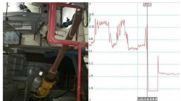
图 1 磨煤机拉杆断裂图及液压油站加载力变化趋势图
