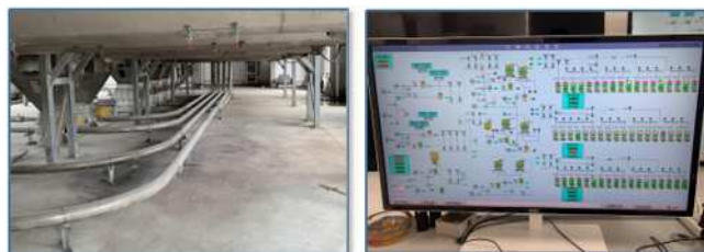
图1 现场图片、中控平台图片
