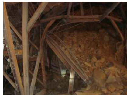
图一、隧洞内的钢拱架变形
