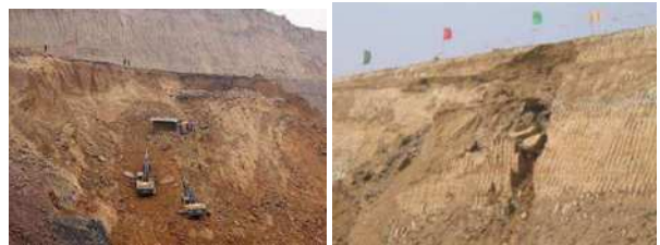
图1 边坡失稳影像
