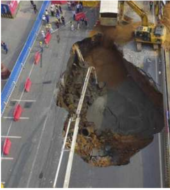
图1 案例：2016年南昌地铁2号线 涌水涌沙导致工程塌陷
