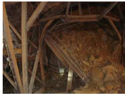
图一、隧洞内的钢拱架变形
