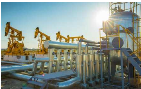
图2 油气输送管道
