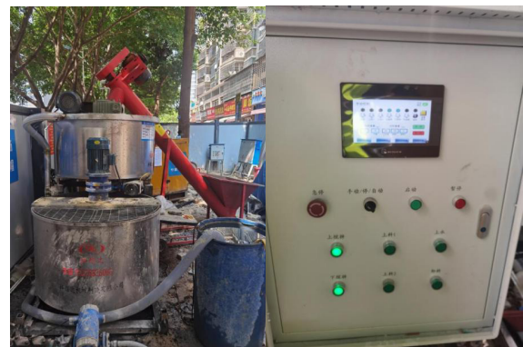
图5 智能化制浆注浆站
